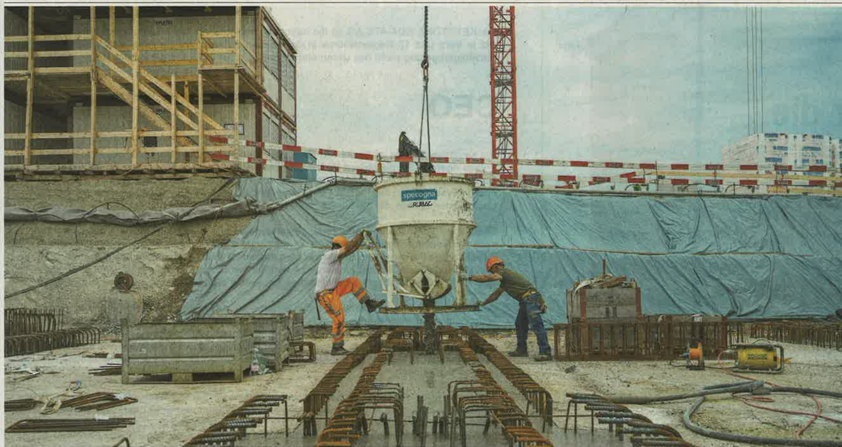
Überbauungen wie «Guggach III» wurden noch zu wesentlich tieferen Kosten kalkuliert, als heute verrechnet werden. (Zürich, 22. Mai 2022)
